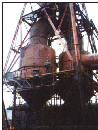
Встроенные каплеуловители из стеклопластика на Магнитогорском металлургическом комбинате
