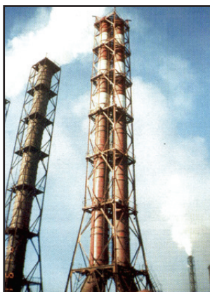
Два газоотводящих ствола D = 2,8 м из стеклопластика со встроенными каплеуловителями из стеклопластика, установленные на Магнитогорском металлургическом комбинате взамен алюминиевого ствола D = 4 м
