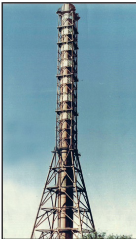
Труба из слоистого пластика на основе фаолита (диаметр 7,0 м, высота 150 м), в ПО «Химволокно» (г. Черкассы)
